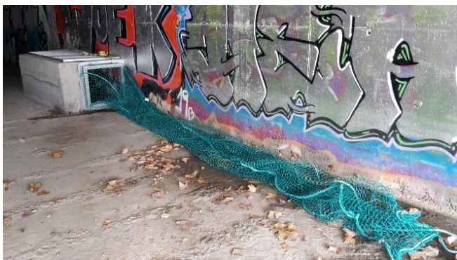
Sacs pluvials per a la retenció de sòlids a tres sobreexidors
