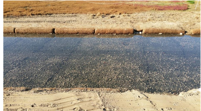
Vista de la llera plena d'aigua amb els gabions, els biorolls i la manta orgànica
