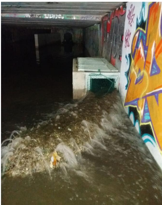
Sac pluvial en funcionament
