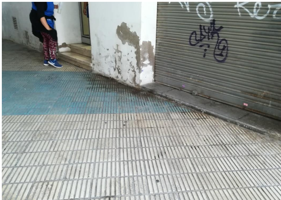
Sanejament i pintura de murs i col·locació de sòcol de color groc en tot el passatge.
