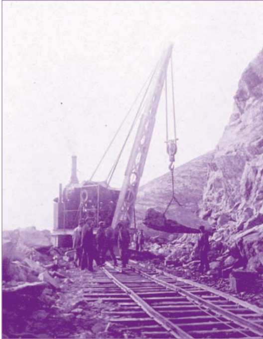
Treballs de construcció dels túnels del Garraf entre 1878 i 1881. Fons documental del Museu del Ferrocarril de Vilanova i la Geltrú.
